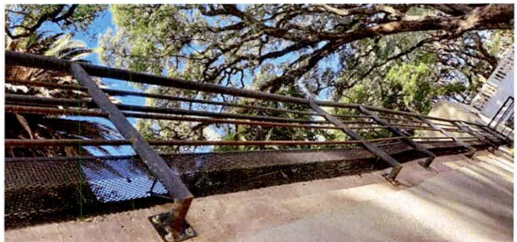
Mayo 2023: barandas oxidadas
